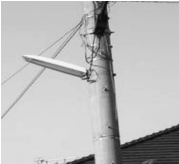
市内の防犯灯
